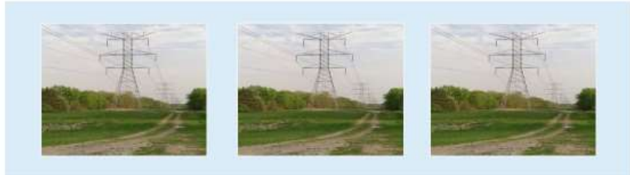
3 - 345 kV Double Circuits
